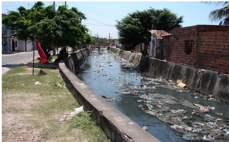
Figura 31 - Foto do canal que alimenta o Santo Anastácio, mostrando as casas construídas irregularmente nas suas margens
