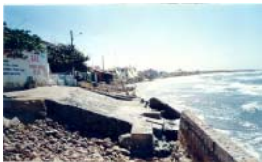
Figura 3 – Destruição do muro de proteção.
