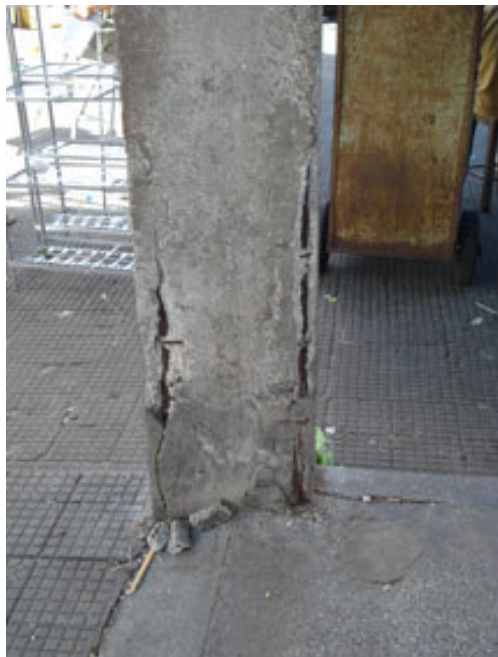
Foto 12 – Problema na estrutura do mercado de abastecimento
