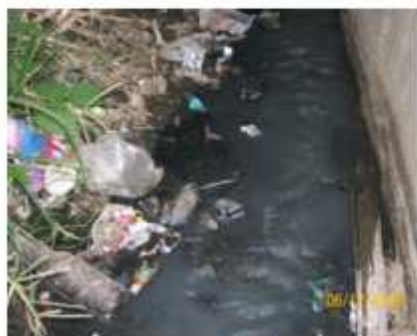
Figura 03: Lançamento de efluentes domésticos.
