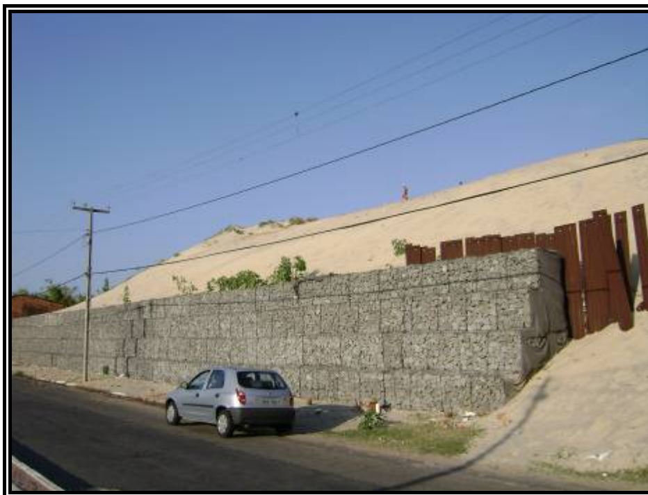
Figura 69 - Muro construído na duna da Barra do rio Ceará, inútil forma de contenção de sedimentos. Foto: Mônica Pinheiro (Maio/2009).
