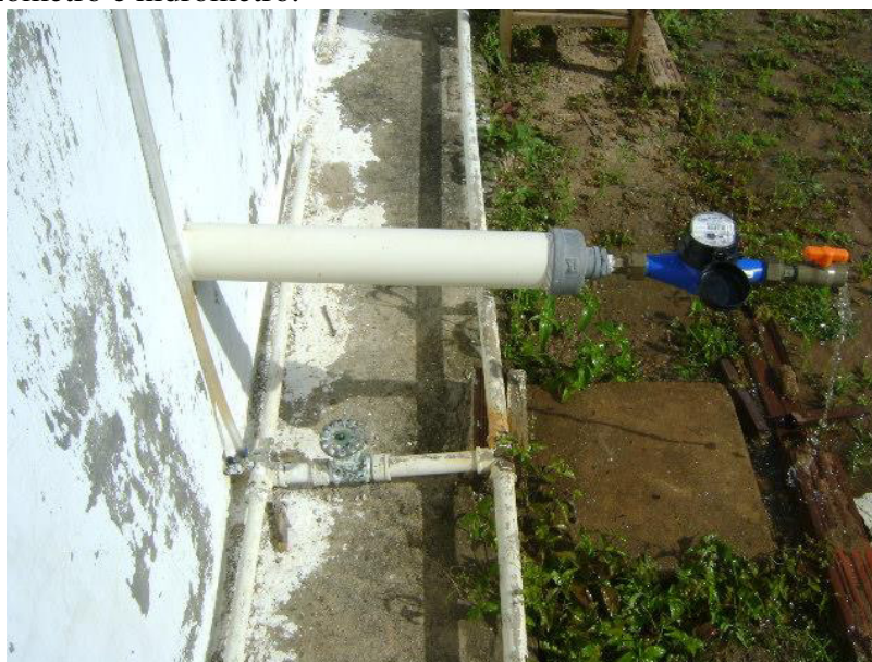
Figura 2 - Piezômetro e hidrômetro.
