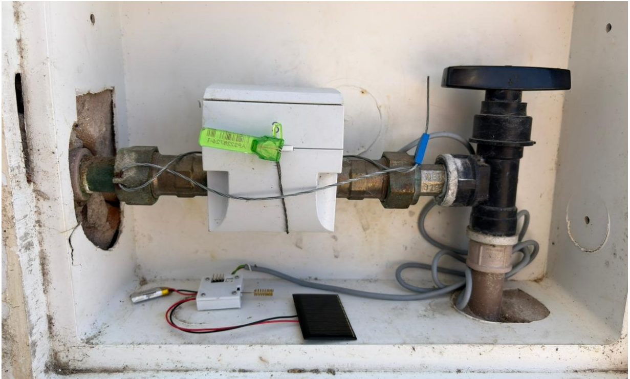
Figura 28 – Protótipo instalado no ponto principal de medição da residência.
