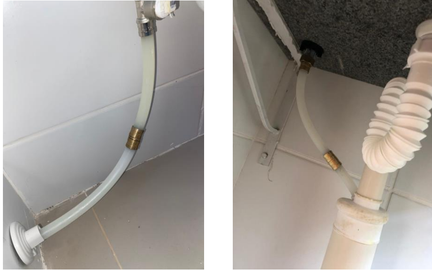
Figura 19 – Exemplos de módulo com adaptações em virtude de medida insuficiente
