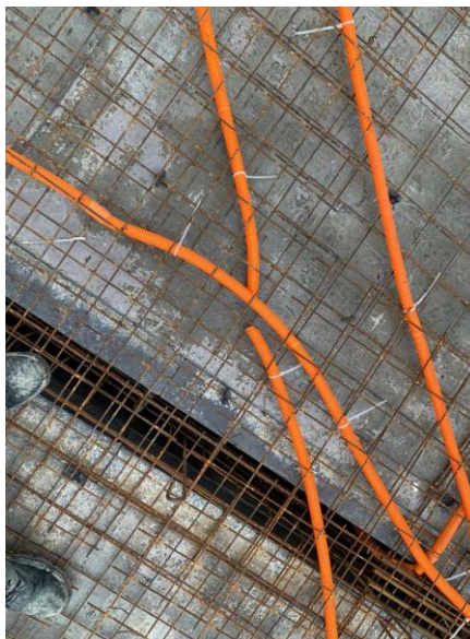
Figura 20 - Exemplo de eletroduto partido em laje
