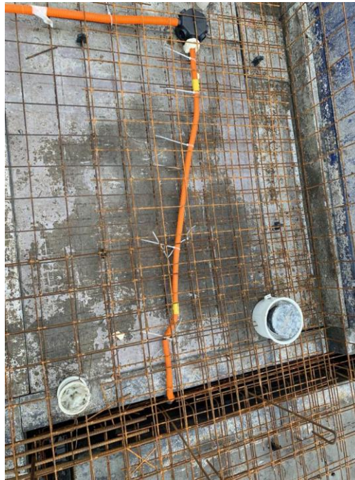
Figura 22 - Exemplo de eletroduto com adaptações em laje
