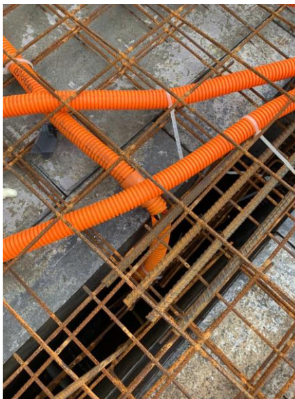
Figura 21 - Exemplo de eletroduto partido em descida para parede de concreto
