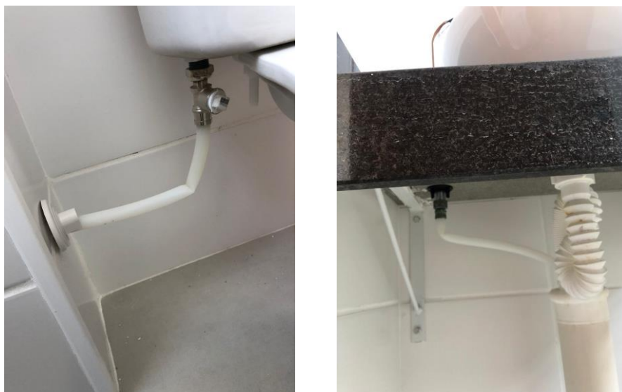
Figura 18 – Exemplos de módulo defeituoso em virtude de material excedente
