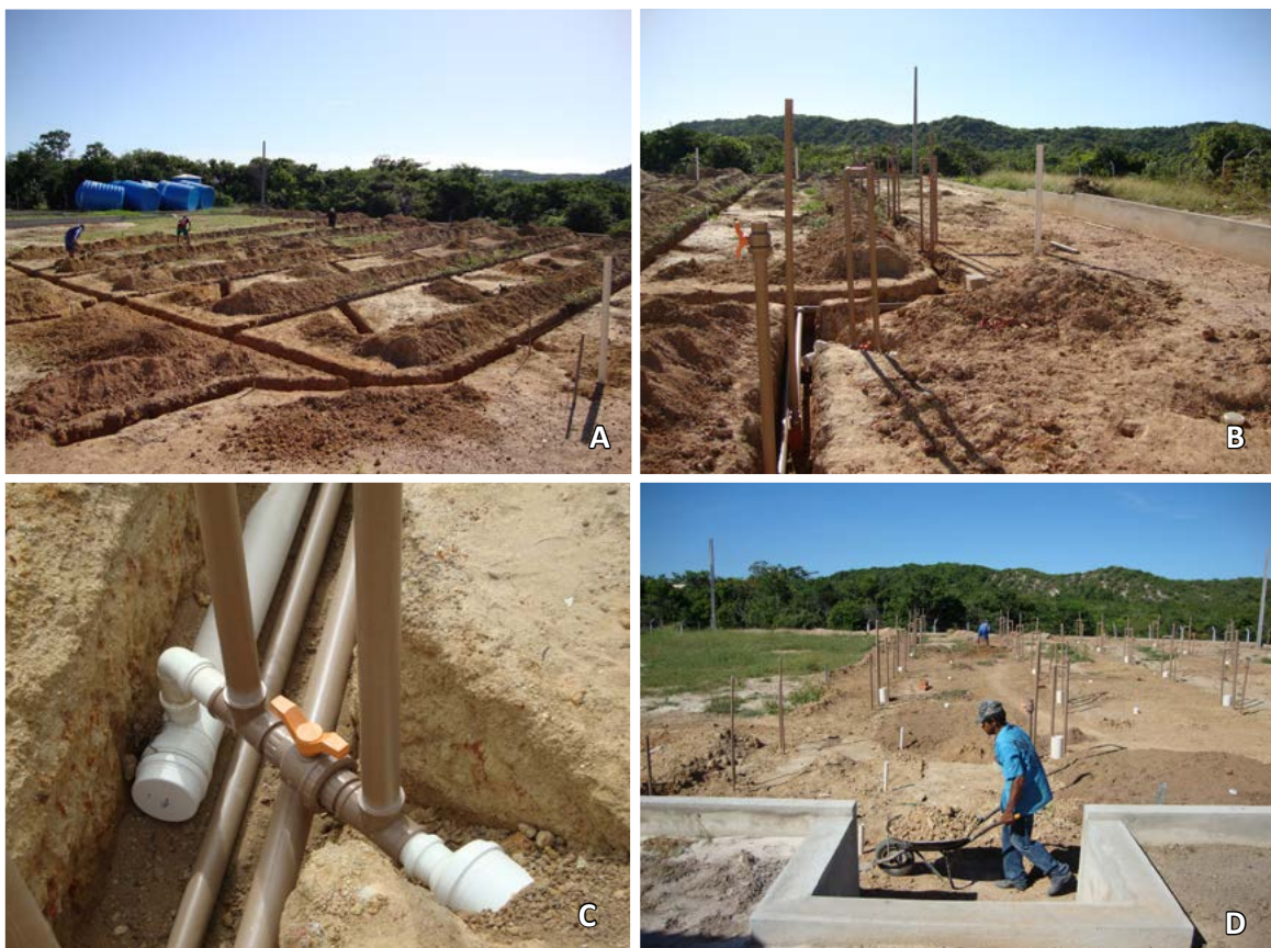
FIGURA 3.5. A, escavação de valas para instalação das linhas de abastecimento de ar e água e drenagem de água. B, cavalete de nível próximo ao sistema de abastecimento de ar e água de um tanque; C, base do cavalete de nível mostrando a conexão ao dreno central do tanque e a linha de drenagem de efluentes. D, tubulações finalizadas. Fotos: Ricardo Camurça Correia Pinto.
