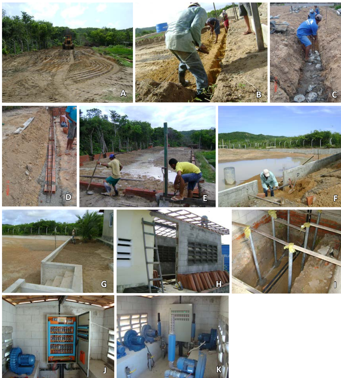
FIGURA 3.4. A-G, etapas da construção do pátio para instalação de tanques de cultivo de peixes marinhos e reservatórios para armazenamento e tratamento de água salgada. H-K, etapas da construção da casa para abrigar compressores radiais de ar. Fotos: Alberto Nunes e Ricardo Camurça Correia Pinto.
