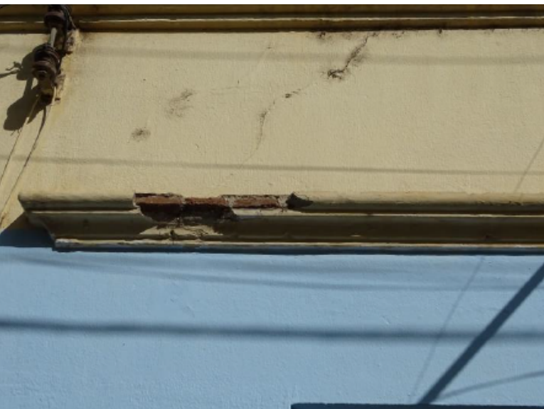
Figura 32: Detalhe de adorno da fachada danificada Fonte: Prefeitura de Limoeiro do Norte
