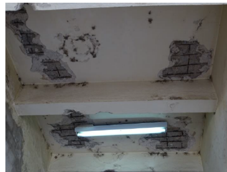
Figura 30: Corrosão causada por vazamentos de água no reservatório localizado acima da laje. Fonte: Prefeitura de Limoeiro do Norte
