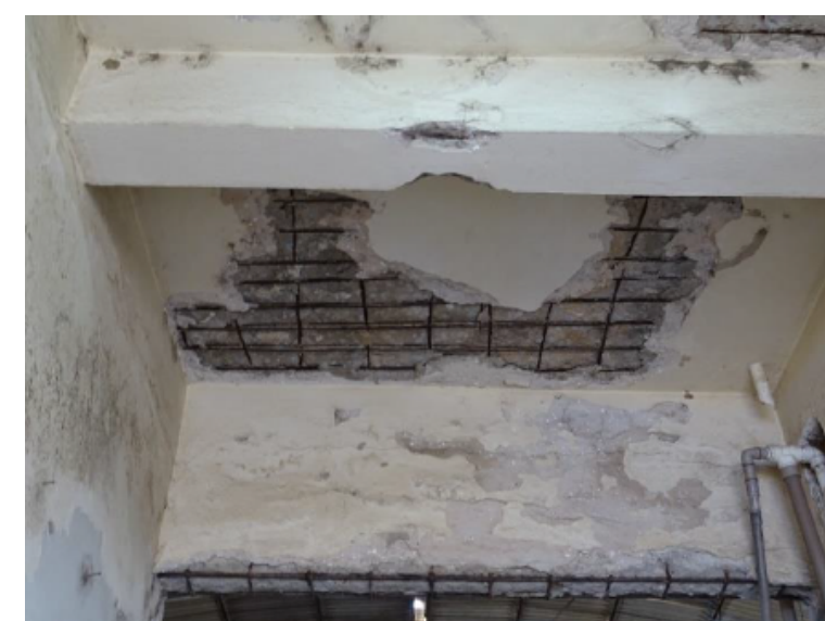
Figura 31: Corrosão causada por vazamentos de água no reservatório localizado acima da laje. Fonte: Prefeitura de Limoeiro do Norte
