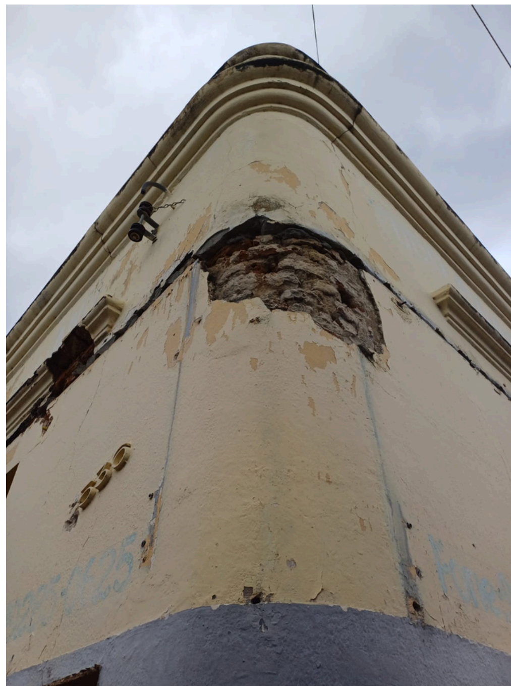
Figura 45: Problemas no reboco da fachada Fonte: Acervo do autor
