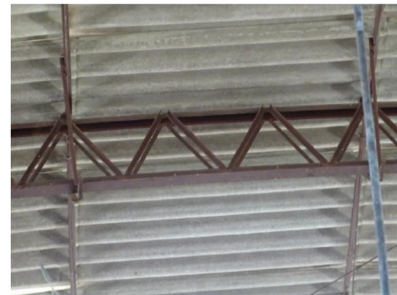
Figura 34: Detalhe da estrutura metálica com sinais de corrosão causados pela ação da carbonatação e falta de manutenção. Fonte: Prefeitura de Limoeiro do Norte
