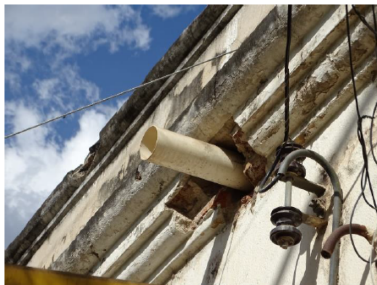
Figura 29: Detalhe da fachada danificado para a passagem de tubo de drenagem de águas pluviais Fonte: Prefeitura de Limoeiro do Norte
