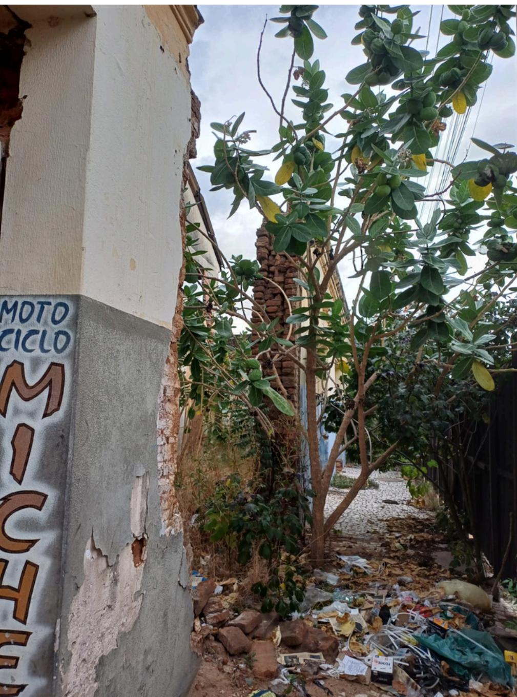
Figura 44: Vegetação invasora com a fachada em ruínas Fonte: Acervo do autor
