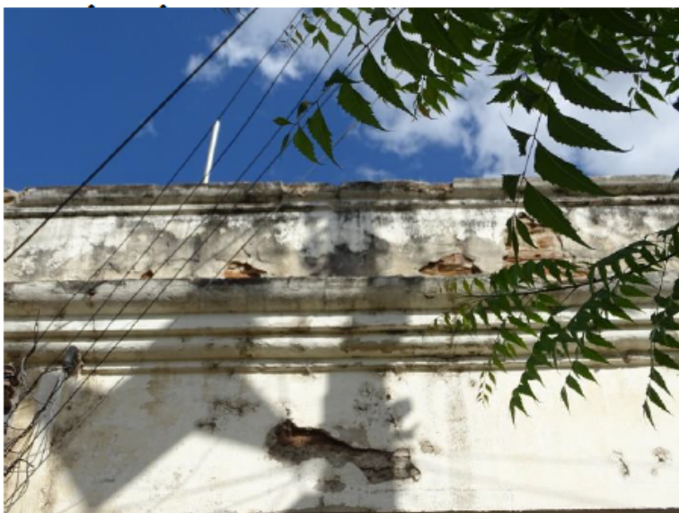
Figura 28: Vista da fachada oeste revestimento danificado.. Fonte: Prefeitura de Limoeiro do Norte
