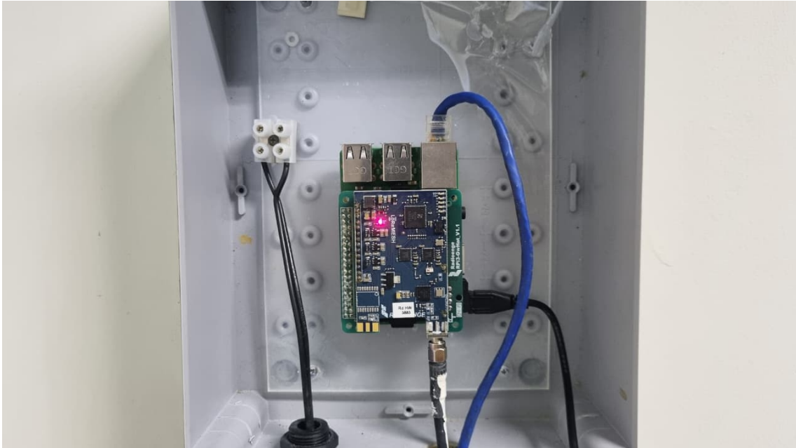
Figura 51 – Gateway LoRaWAN (baseado em Raspberry Pi 3 e módulo RadioEnge) instalado na sala do NTIC.
