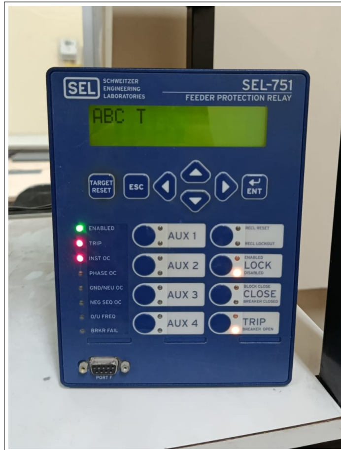
Figura 46 – Relé após a atuação da função 50
