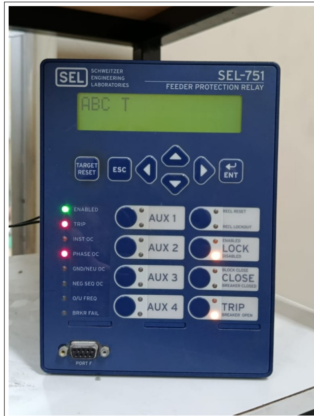
Figura 51 – Relé após a atuação da função 51
