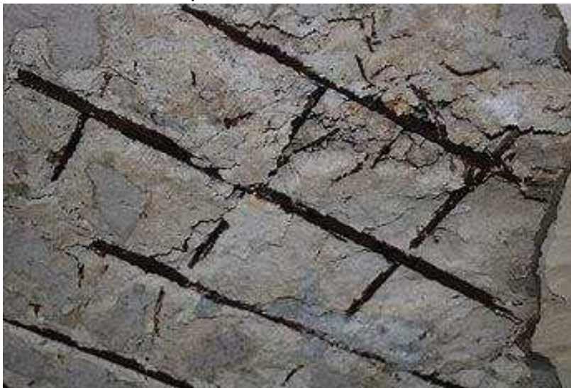
Figura 1 - Armadura aparente em elemento de concreto armado
