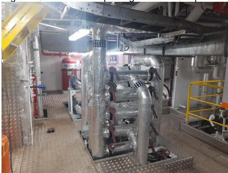
Figura 25 – Sistema de passagem do HFO aquecido
