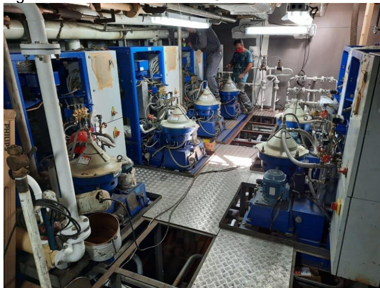
Figura 17 – Purificador de HFO e óleo lubrificante
