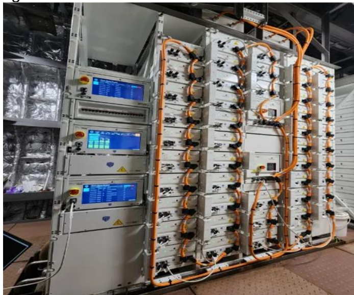
Figura 13 – Pacote híbrido de bateria de 12 MWh
