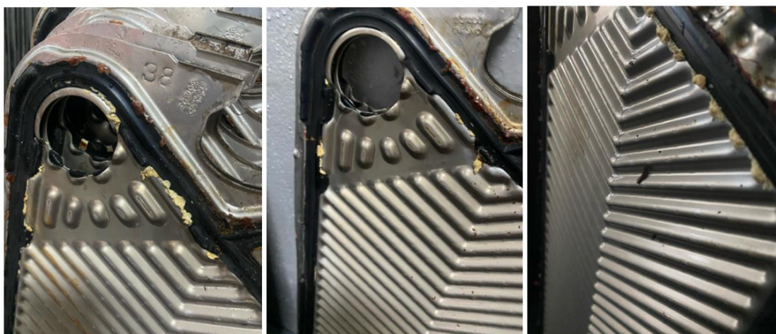
Figura 6 – Placas retiradas do trocador de calor após abertura do equipamento
