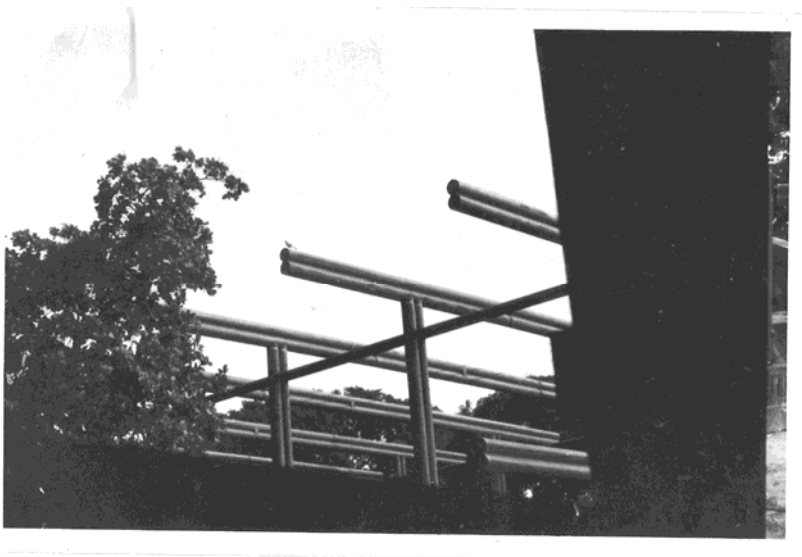
33. Sérgio Bernardes. Palácio da Abolição, 1970. Sistema estrutural. Fonte: arquivo Rui Filgueiras Lima.
