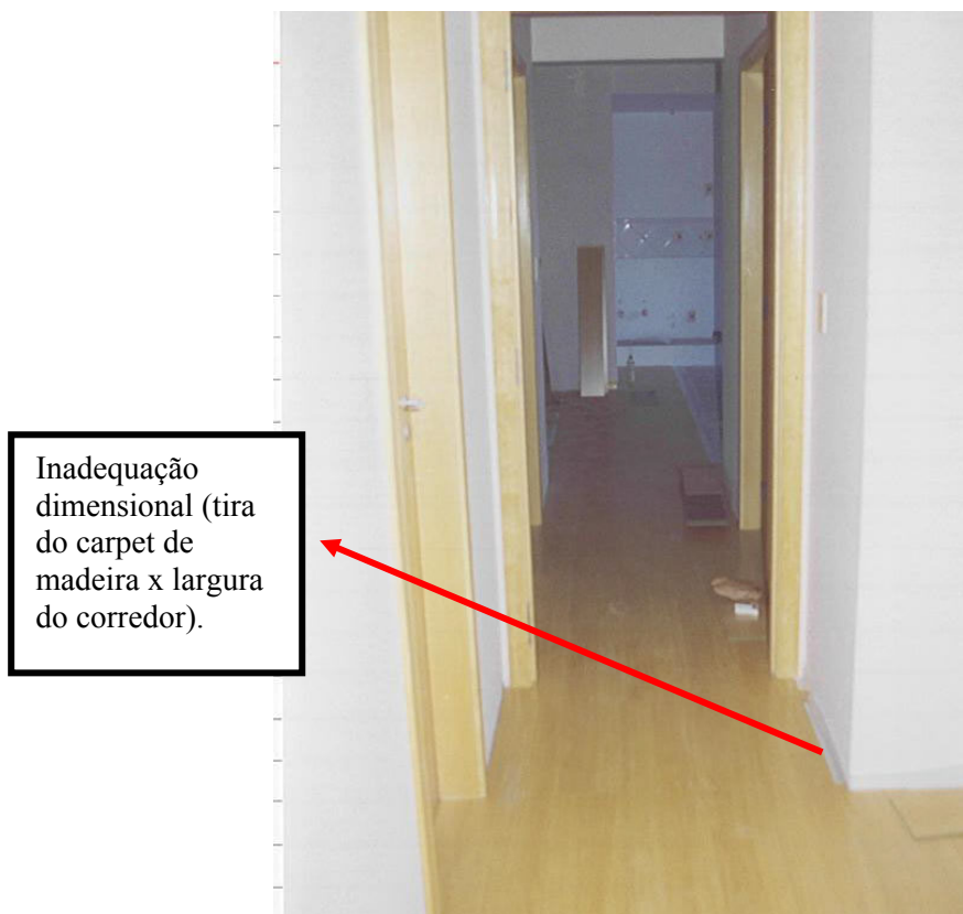
Figura 2 – Retrabalho devido à falta de construtibilidade (inadequação dimensional)
