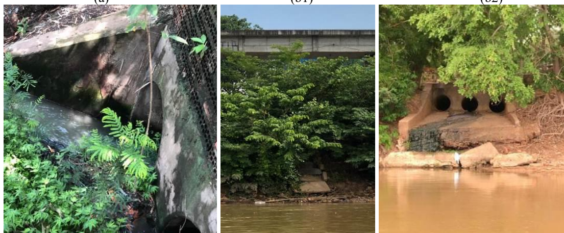
Figura 30 – Setor C entre P05 e P06, esgoto perene (a) e esgotos intermitentes (b1 e b2)
