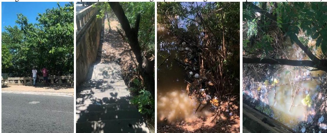
Figura 22 – Mureta de proteção, escadaria vegetação, lixo e esgoto entre os pontos 3 e 4 (P03 e P04)
