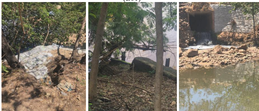
Figura 11 – Setor A, P03, erosão do solo, medidas de controle (sacos de contenção) e saída de esgoto (E01)
