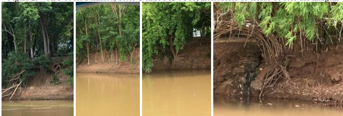
Figura 29 – APP do rio Parnaíba, Setor C entre P05 e P06, indicadores de erosão do solo das margens
