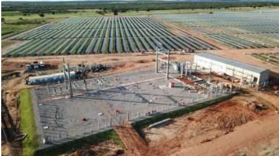
Figura 15 - A Subestação Coletora Bon Nome de 34,5/138kV em Pernambuco
