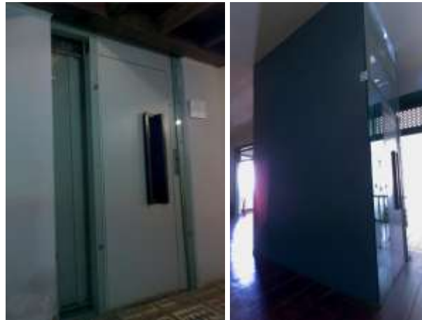
Figura 14 - Elevador de acesso do Pavimento Térreo ao 3º Andar
