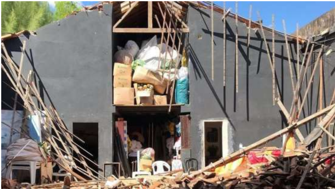
Figura 23 – Imagem de parte da estrutura do Teatro da Praia após desabamento
