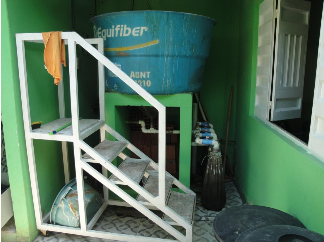
Figura 4.2 – Tanque de contato para adição de NaOH ao efluente galvanoplástico.
