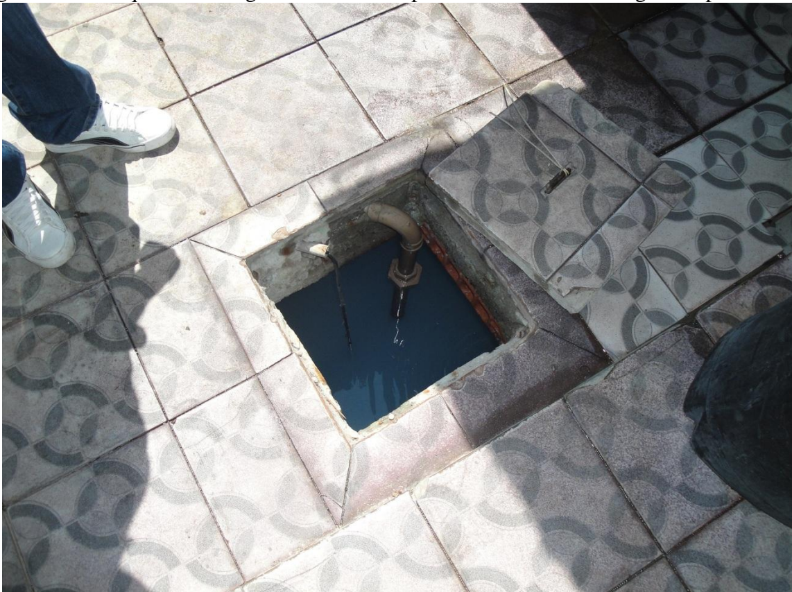
Figura 4.1 – Tanque de estocagem dos efluentes provenientes dos banhos galvanoplásticos.
