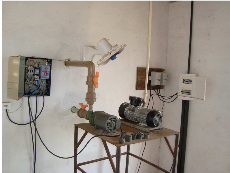
Figura 10 – Vista geral da sala de bombas, motor de transferência, bomba de vácuo, inversor de frequência e caixa de comando, Aracati-CE (2012).
