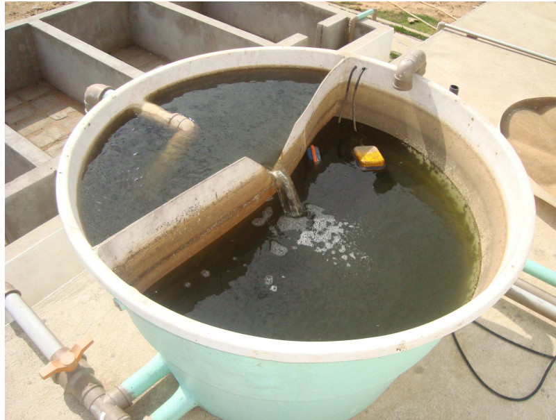
Figura 9 – Tanque de homogeneização com volume útil de 500 litros instalado no sistema de tratamento e com flange de fibra de vidro, Aracati-CE (2011).
