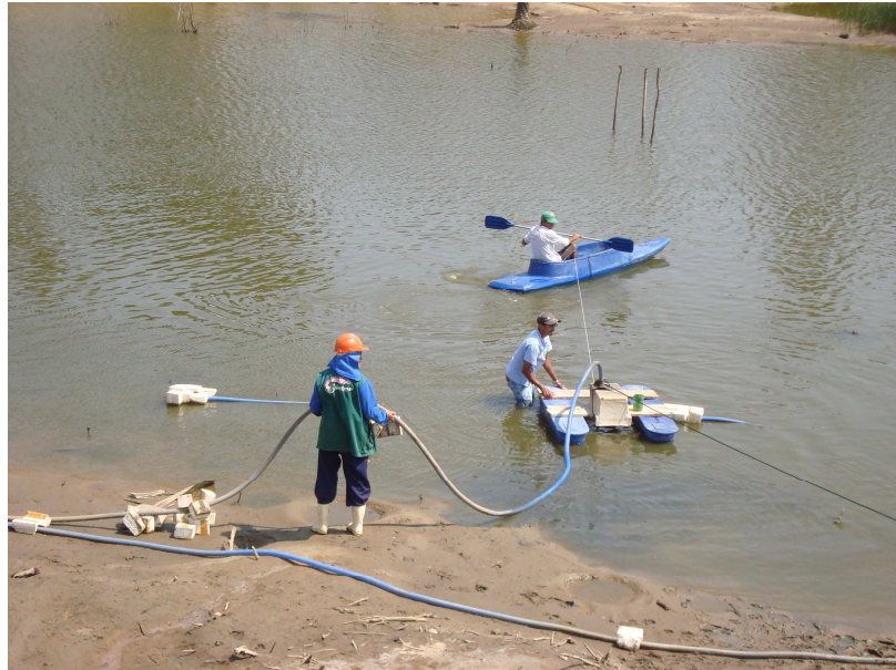
Figura 7 – Vista geral da fixação do motor na bacia de sedimentação, o qual foi responsável por captar e transferir os efluentes armazenados para ETE experimental, Aracati-CE (2011).
