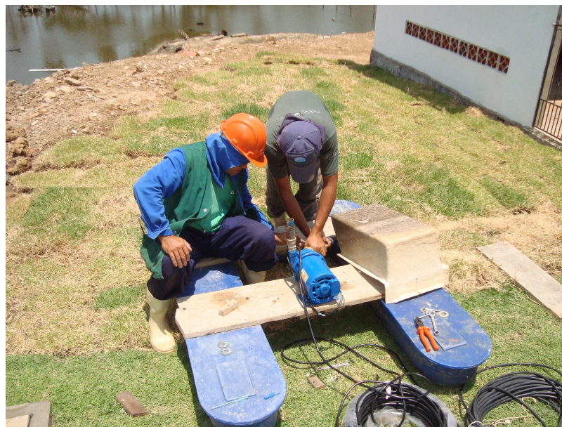
Figura 6 – Adaptação do motor sobre flutuantes para captação do efluente de despesca de camarão, Aracati-CE (2011).
