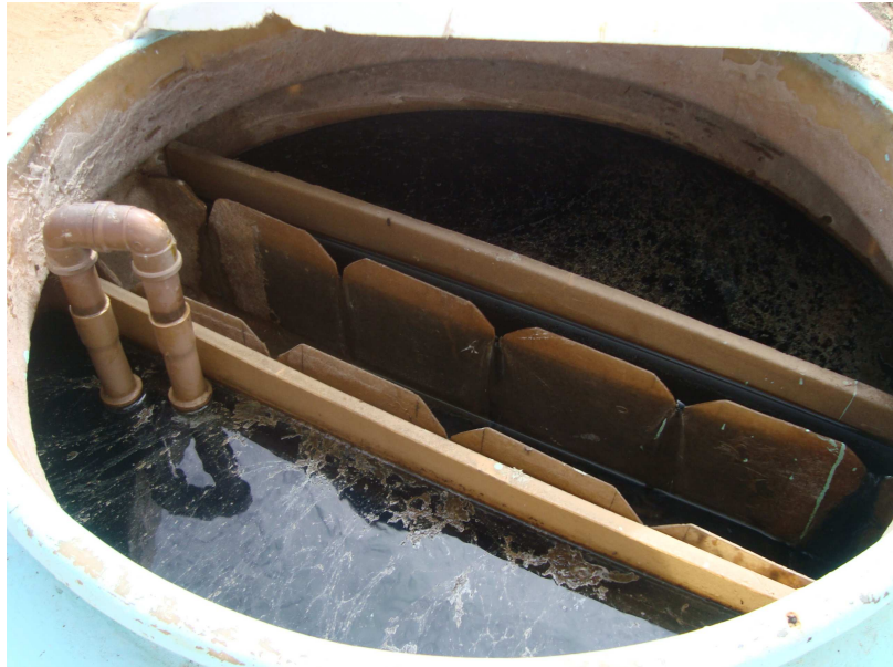
Figura 17 – Vista geral da calha coletora do efluente tratado do reator UASB, Aracati-CE (2011).
