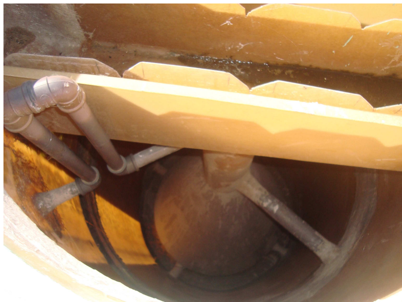
Figura 16 – Vista geral do separador trifásico do reator UASB, Aracati-CE (2011).
