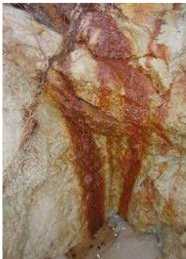
Figura 22: Aspectos da oxidação nas falésias da Praia das Fontes.
