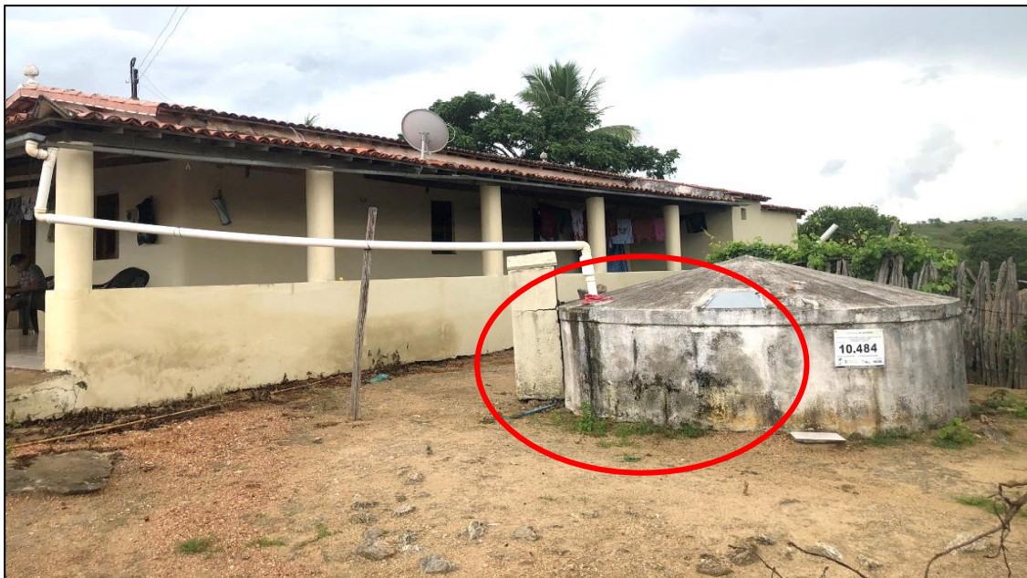
Figura 24 - Falta de manutenção na cisterna, Vale do Forquilha.
