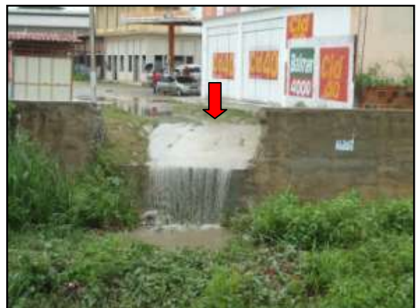
Figura 55- Escoamento superficial após a quebra das paredes
