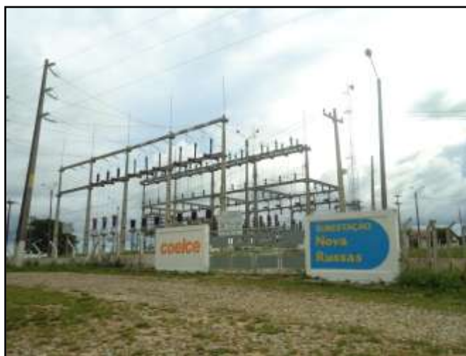
Figura 32- Subestação de energia elétrica de Nova Russas
