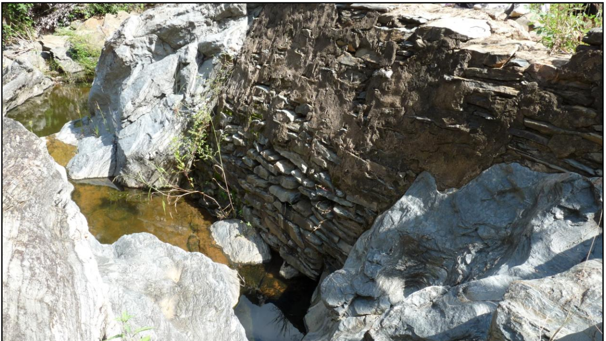
FIGURA – 07. Represa construída pelos camponeses no leito do riacho Caldeirão. Foto: Judson Jorge
