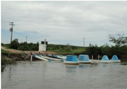
Figura 53.4: Bombas dos tanques da carcinicultura
