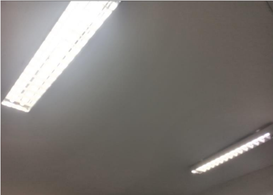
Figura 13: Luminária presente nas salas do bloco 710.
