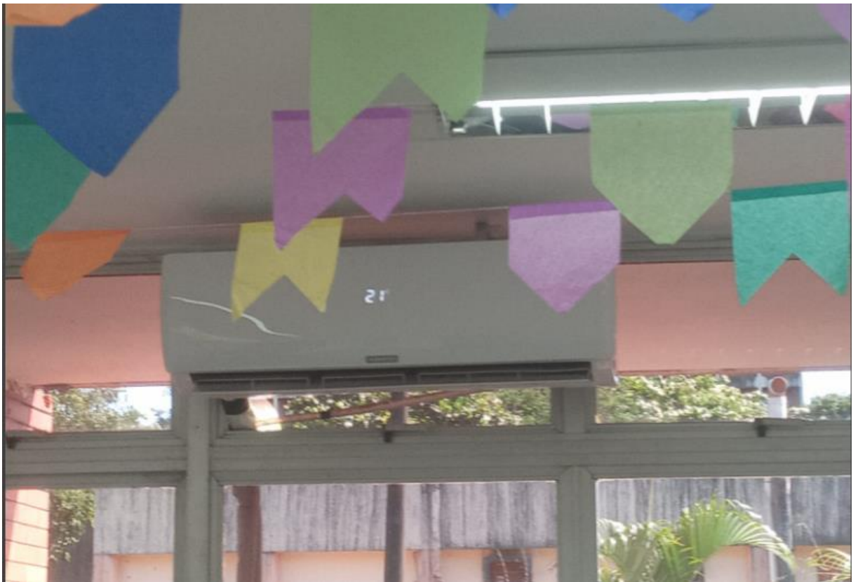
Figura 17: Temperatura do Condicionador de Ar.
