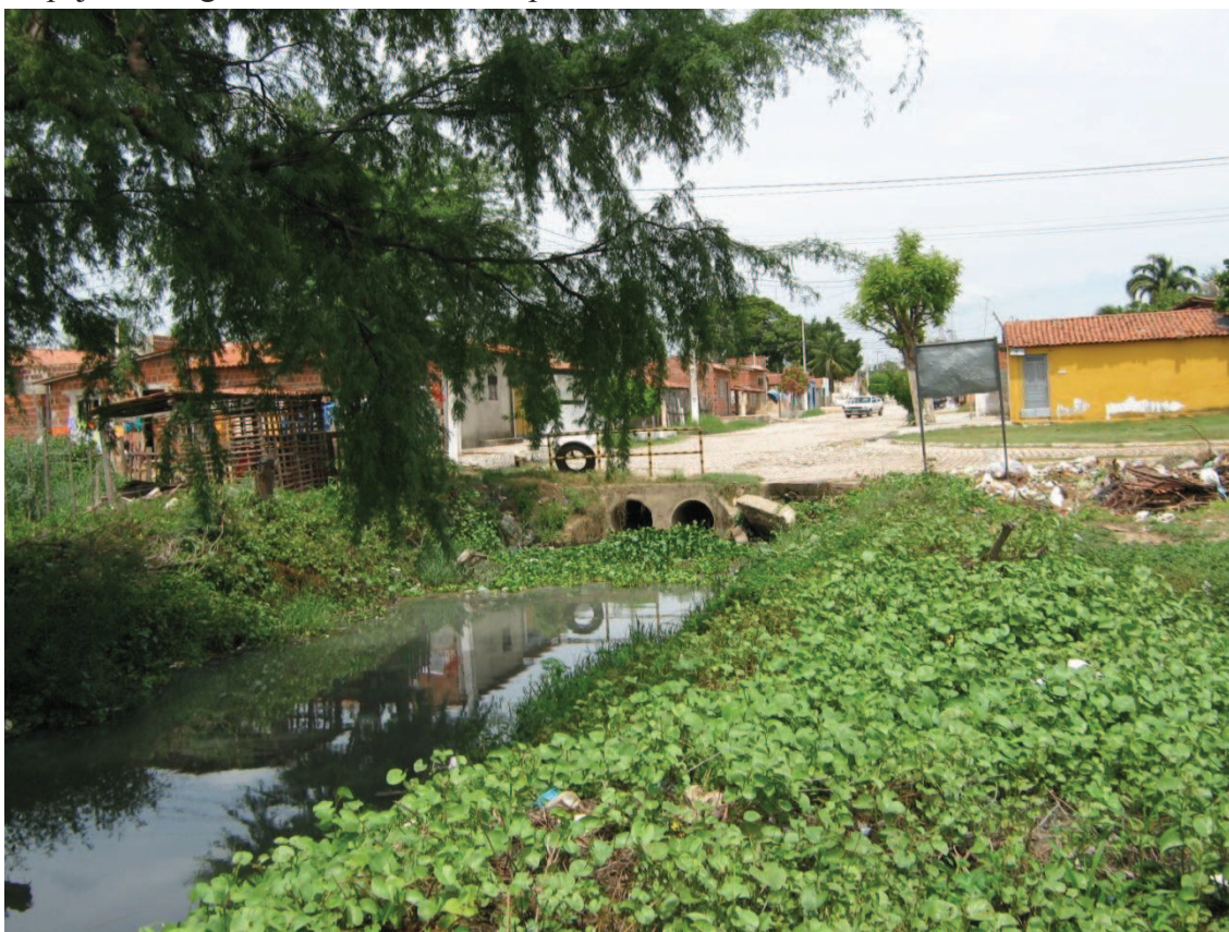
Foto 14 - Periferia de Mossoró na altura do bairro Alto da Conceição, zona sul da cidade, com despejos de esgotos sanitários em via pública.
