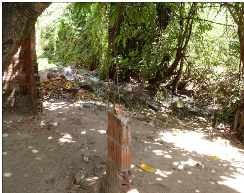
Figura 28 – Maranguape (CE), Muros residenciais destruídos por enchentes. Fonte: Ícaro Maia, 2010.
