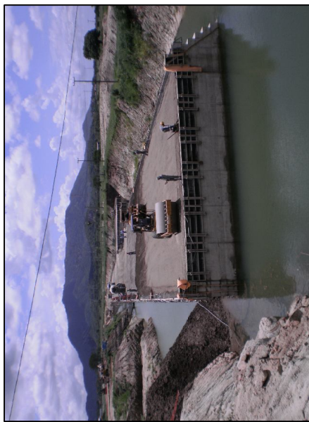
Figura 1.4 – Fotografia das obras da Barragem Maranguapinho em 10/04/2010. Fonte: http://www.panoramio.com . Foto por: Eng. Rafael Costa M. S. Braga.
