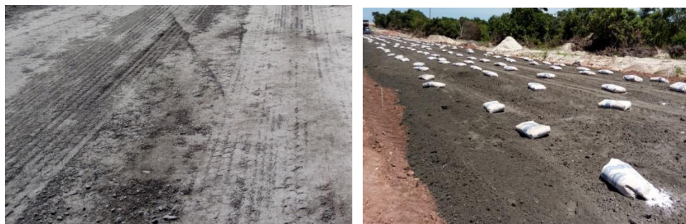
Figura 23 – Problemas na execução da base de cinza-cal: (a) desagregações; (b) espaçamento de cal inadequado
