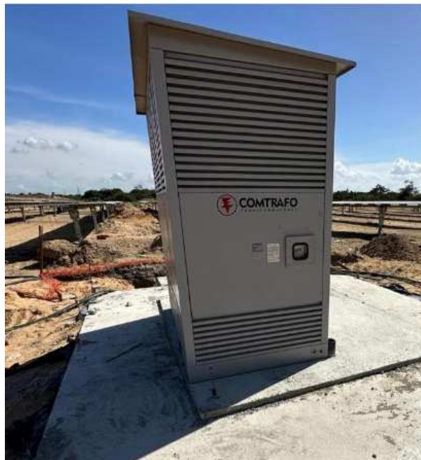
Figura 20 – Transformador elevador 0,8/6,6 kV.
