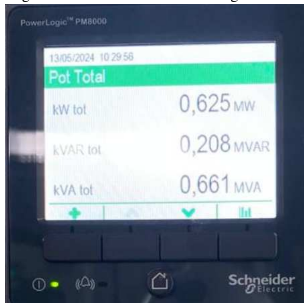
Figura 30 – Multimetro de energia.
