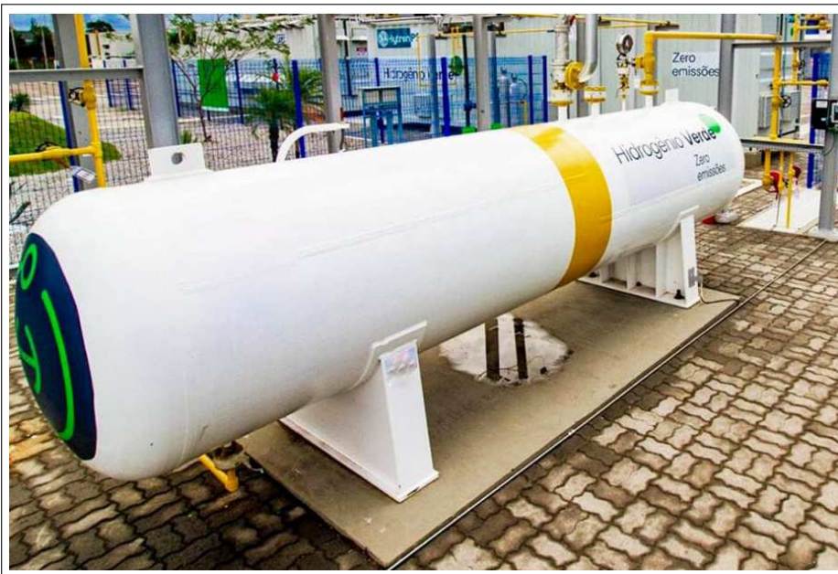
Figura 15 – Tanque de armazenamento de \text{H}_2\text{V} .
