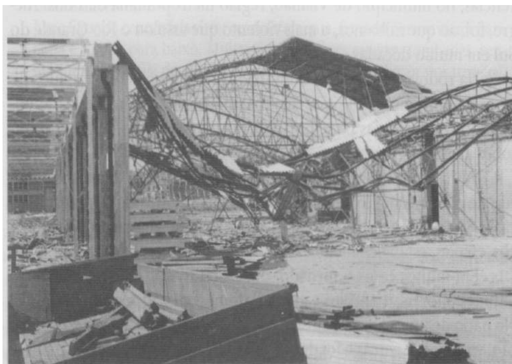
Figura 1.3 – Ventos fortes que arrancaram a cobertura metálica em Guaíba, RS
