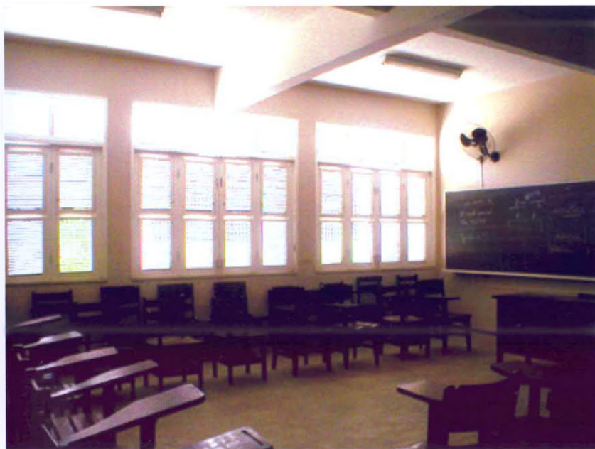
Fig. 3.5 – Vista da sala de aula – Detalhe da esquadria de madeira com venezianas articuláveis.
