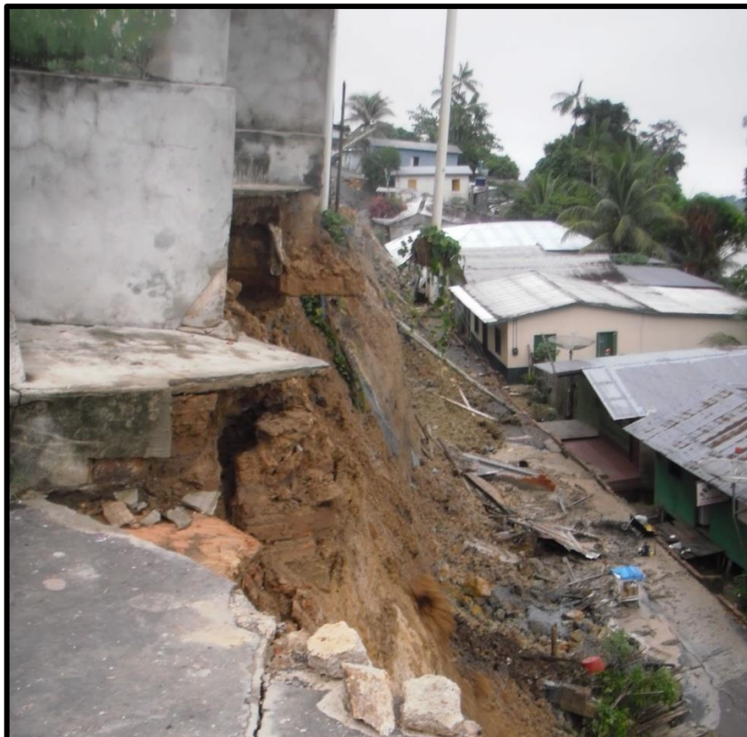
Figura 71 – Casas em risco de desabamento em 11 de outubro de 2010.
