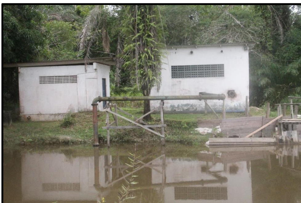
Figura 44 – Estação de captação de água no igarapé Ajaratuba
