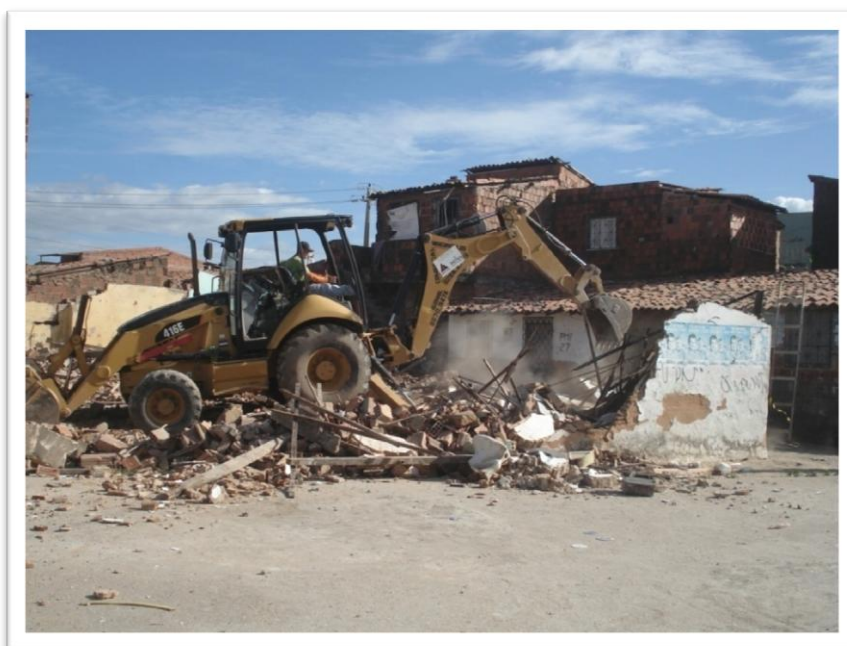
Figura 12: Demolição das antigas casas da área do açude João Lopes (Foto: Zoraia Nunes).
