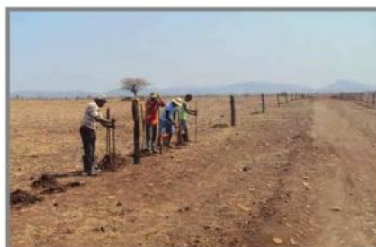
Foto 15 – Camponeses do assentamento Nova Vida I, construindo as cercas das estradas que darão acesso aos lotes
