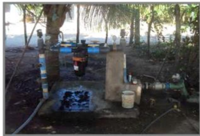
Foto 10 – Tomada de água na entrada de cada lote
