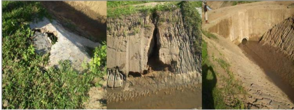
Figura 20 – Danos estruturais a parede do canal adutor e processo de assoreamento
