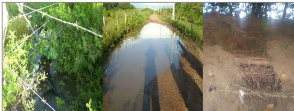
Figura 22 – Problemas com drenos e tomadas d'água e danos a parede do reservatório de captação - barragem de compensação
