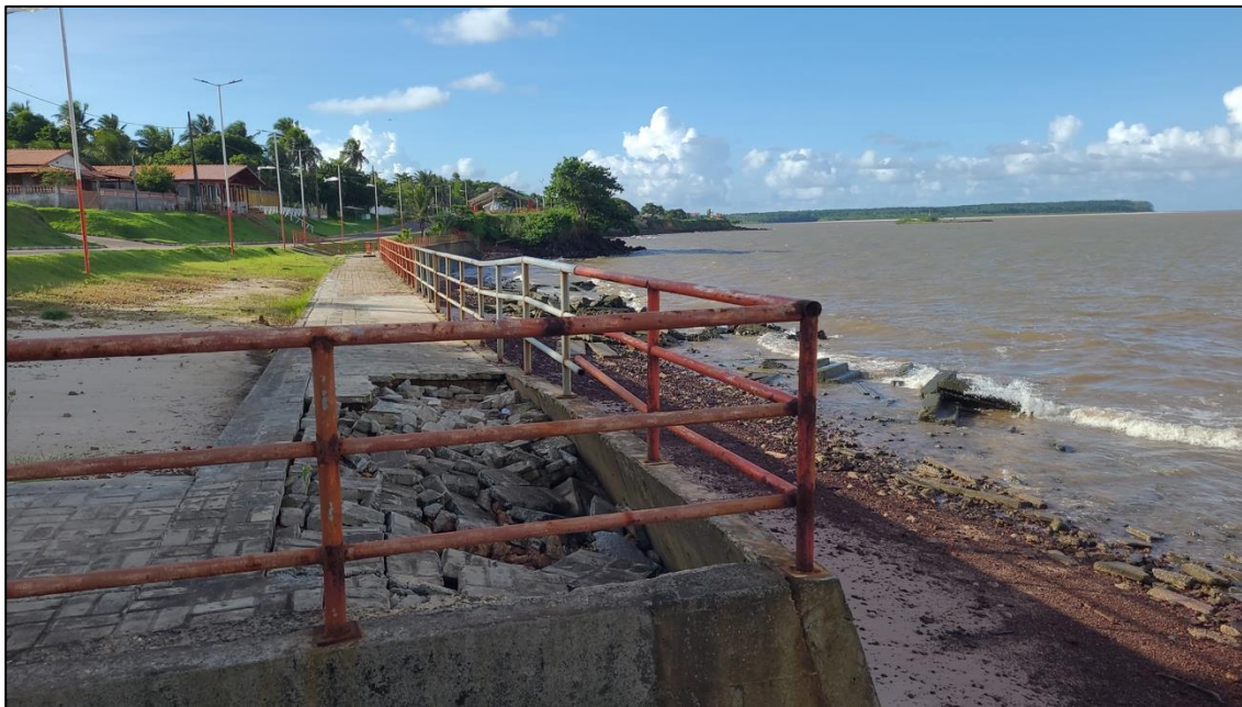
Figura 15 – Orla da Praia Grande sendo erodida
