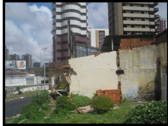
FIGURA 33 – Rachaduras em paredes dos imóveis. FONTE – LIMA, 2007.
