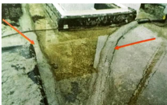
c) Empoçamento em laje devido a chumbamento de eletrodutos sobre o piso. Fonte: Grossi (2021).
