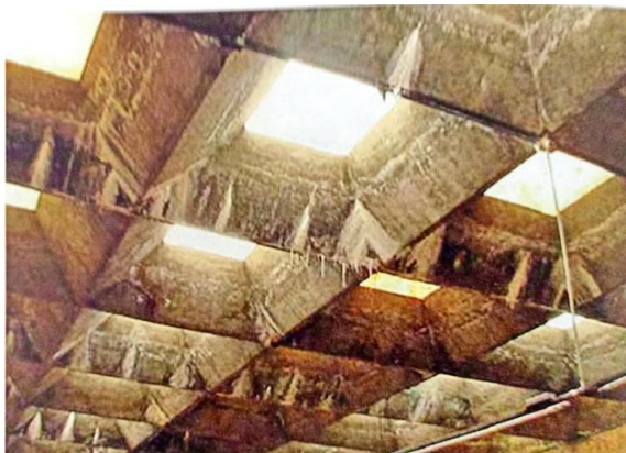
a) Cobertura danificada por chuva ácida. Fonte: Bolina, Tutikian e Helene (2019).
