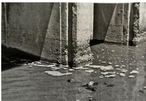
a) Lixiviação do concreto. Fonte: Bolina, Tutikian e Helene (2019).
