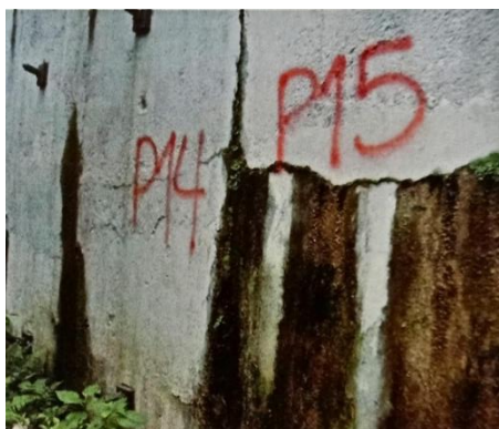
b) Fissura longitudinal em uma cortina atirantada e formação de líquens. Fonte: Bolina, Tutikian e Helene (2019).
