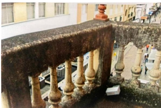
a) Presença de microorganismos no guarda-corpo de uma edificação. Fonte: Bolina, Tutikian e Helene (2019).
