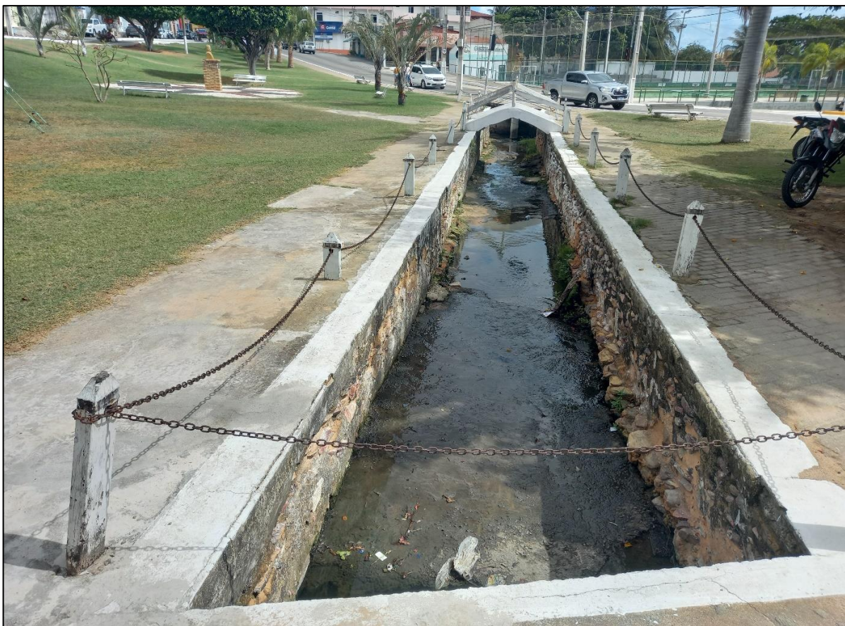
Figura 35 – Córrego com efluentes no centro de Fortim
