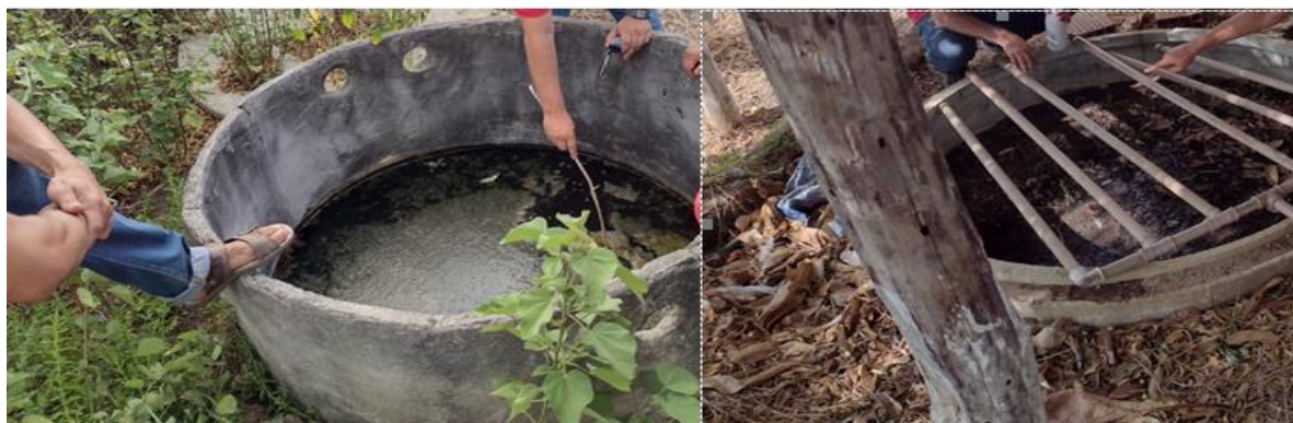
Figura 15 – Implementação do sistema de reúso de águas cinzas da escola
