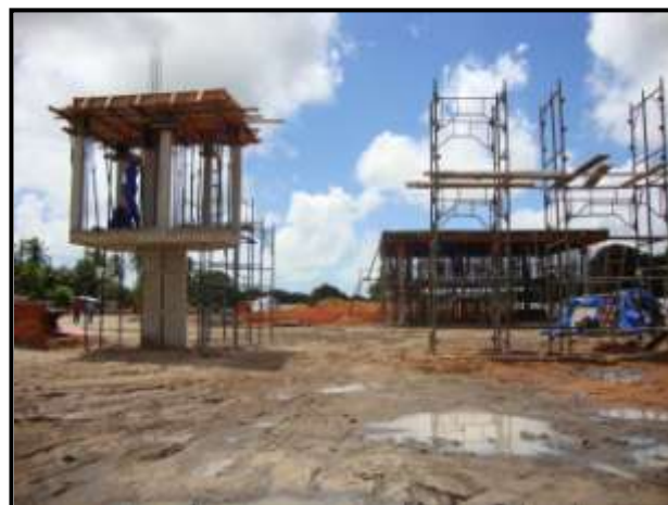
FIGURA 25: Construção do condomínio Nature Village. O terreno de 18.000m 2 era ocupado, anteriormente, por um sítio. Fonte: Nogueira (2011).
