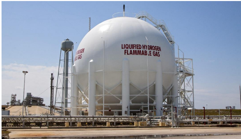
Figura 10 - Tanque de armazenamento de hidrogênio líquido
