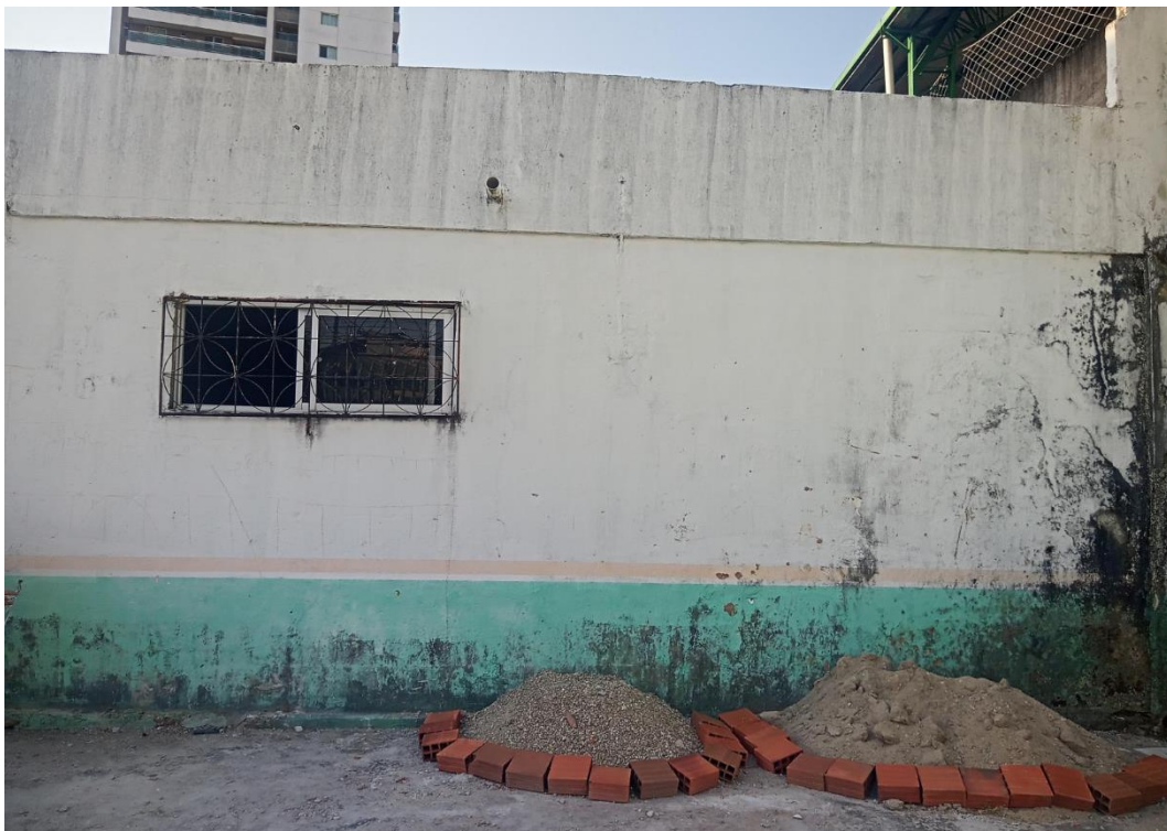
Figura 38 - Restos de material de construção próximos à parede. Fonte: elaborado pelo autor.
