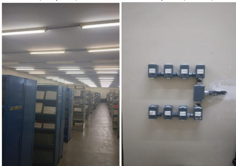
Figura 27 - Setor de referência (à esquerda) e controle com 16 interruptores (à direita).
