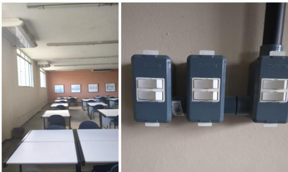
Figura 28 - Salão de leitura do 1º andar (à esquerda) e controle de 72 luminárias (à direita).
