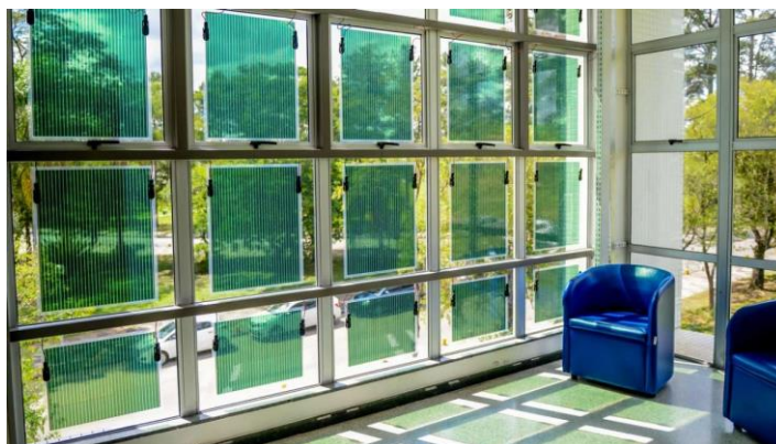
Figura 21 - Placas solares orgânicas instaladas no Departamento de Física da UFPR
