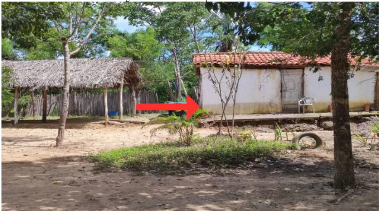
Figura 17 – Marca d'água em uma residência situada muito acima do leito do Rio Saco. O evento em questão ocorreu em 10/04/2023 e a foto foi registrada uma semana depois
