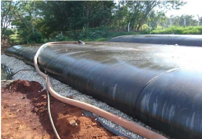
Figura 13 – Drenagem ETE Cel. Macedo (SABESP)
