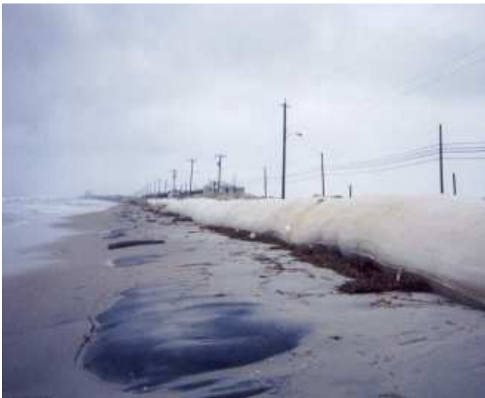
Figura 9: Estrutura em tubo de geotêxtil depois da tempestade
