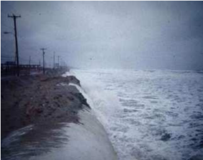
Figura 8: Estrutura em tubo de geotêxtil durante uma tempestade
